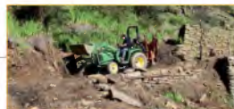
Entretien général et restauration des murs hauts sur les restanques de Saint-Clair.
