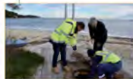
Déplacement et remplacement du poste de relevage de Saint-Clair. 1 re phase - dévoisement des réseaux gravitaires
